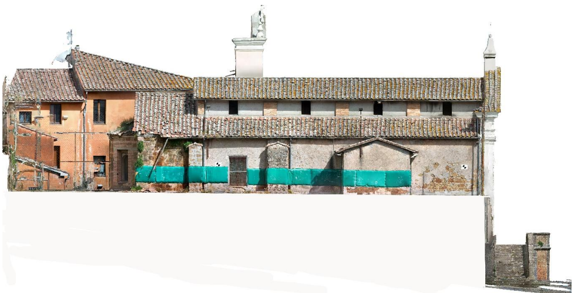
Vista del prospetto esterno con linea di gronda gravemente ammalorata
