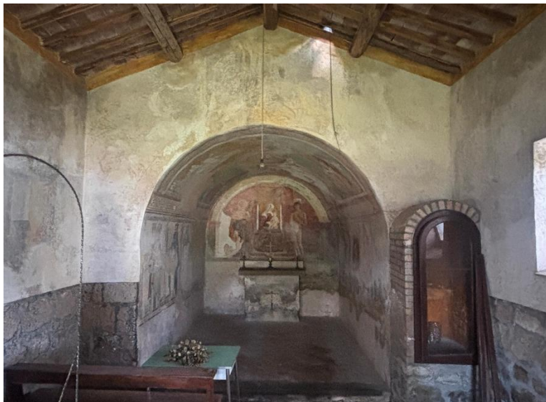
Fig. 1: In alto: foto realizzata durante il sopralluogo del 27.02.2025.
