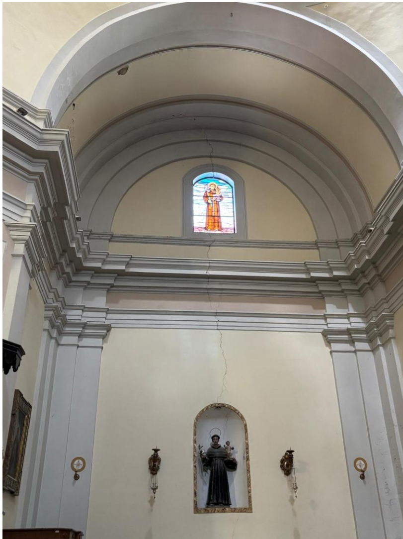
Veduta di una lesione passante nel braccio laterale della croce greca
